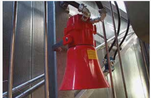
Alarm akustyczny w elektrowni gazowej: 🔊-Syrena BExS 120 ATEX.
