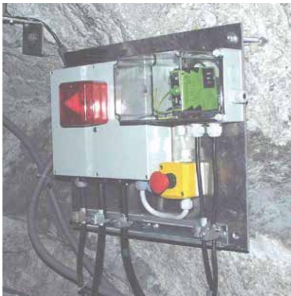
Rys.: kompaktowa lampa błyskowa PY X-S-05 zastosowana w tunelu, zakres napięcia wejściowego: 70–264 V AC / 73–140 V DC (sieć/bateria)
